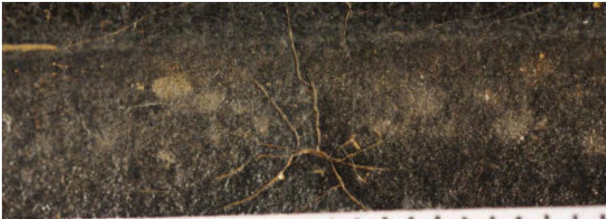
Vor der Abnahme der Ansammlung von Staub und Schimmel
