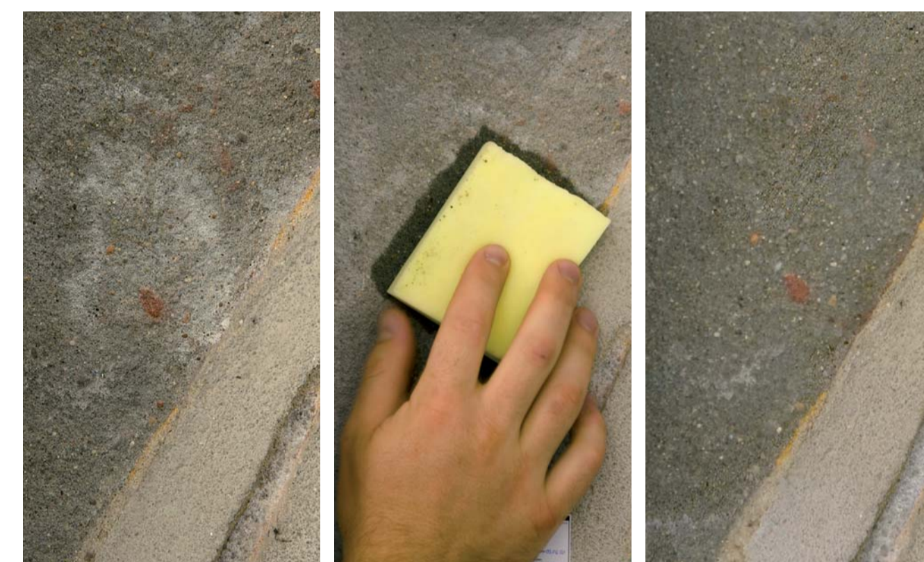
Salzreduzierung mit Saugschwämmen: Durch das kontrollierte Ausdrücken und Loslassen des Schwammes auf der Oberfläche wird die oberste Kornlage des Putzes durchspült und der Salzgehalt reduziert.
