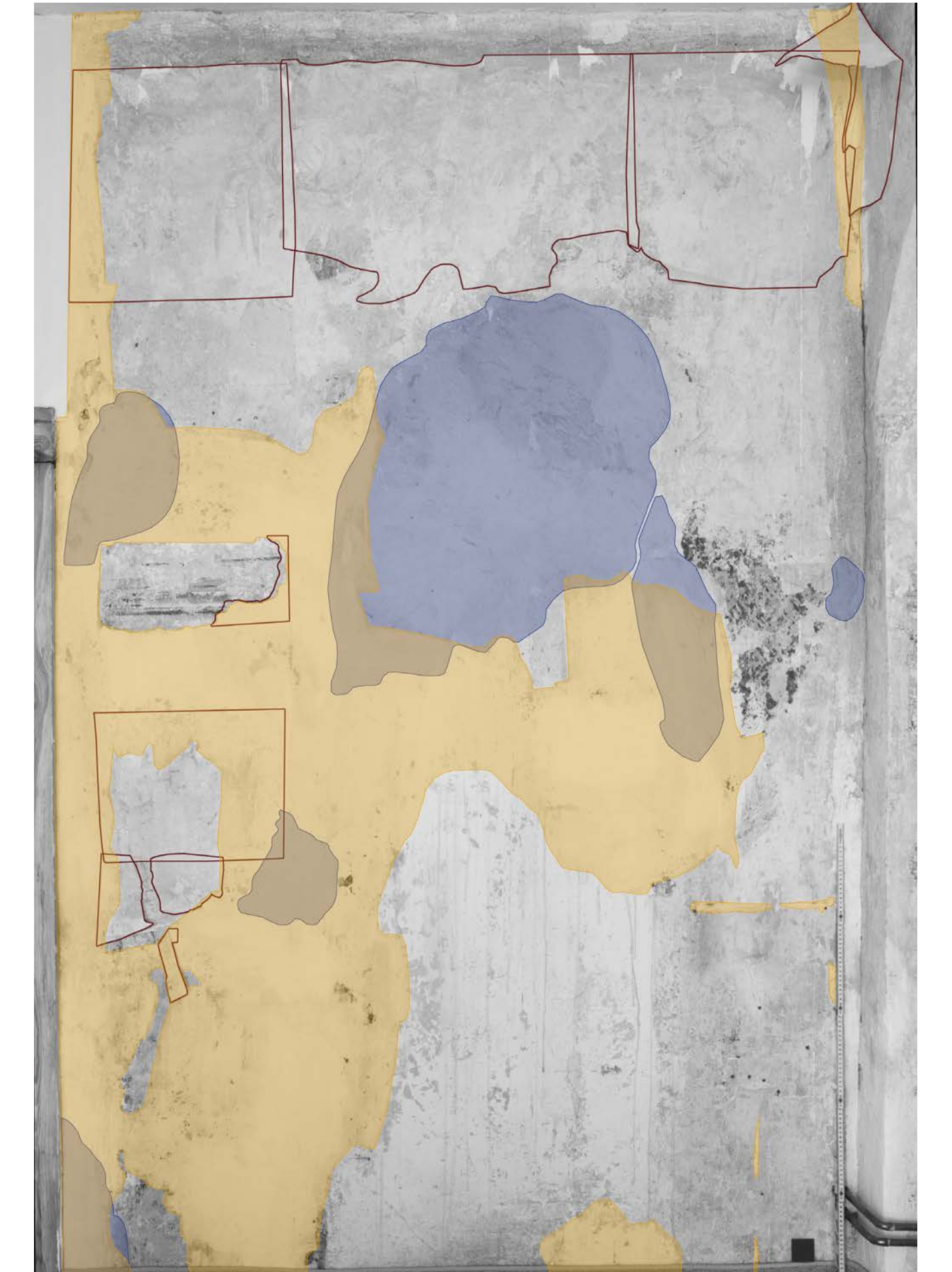
Bestandskartierung junger Substanzauflagerungen ab 1991, Nordwand (rot: Japanpapierkaschierung von 1993, blau: zementgebundene Putzmörtelergänzung, gelb: Gipskittmasse)
