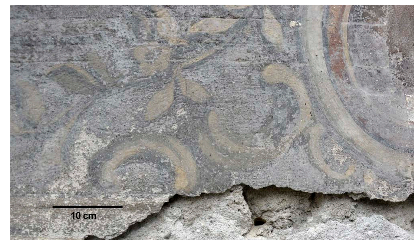
Schalenbildung im Putzbestand sowie Vergrauung der Wandmalerei im Bereich der Architekturmalerei im Erdgeschoss
