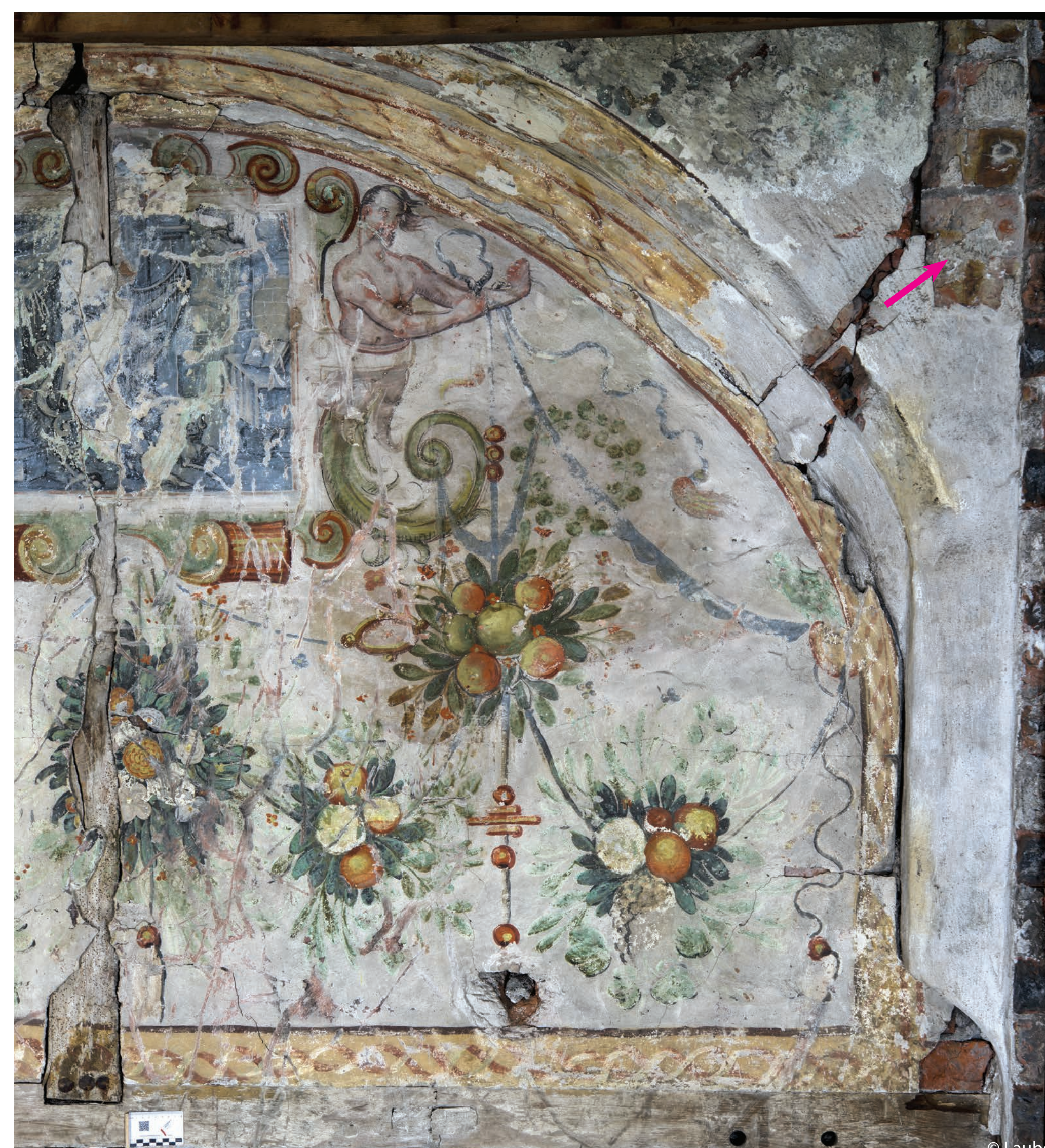
Abb. 10: Östliche Hälfte des Bogenfelds und des Segmentbogens sowie das östliche Zwickelfeld vor der Ausführung der Maßnahmen. In der rechten oberen Ecke (Pfeil) befindet sich die Musterfläche zu den Chorwänden.
