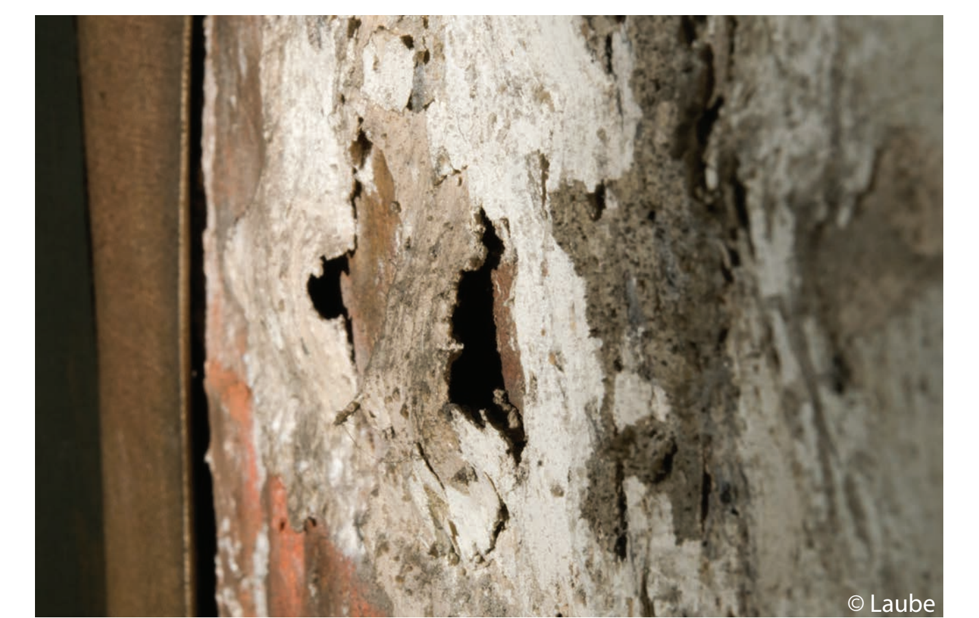
Abb. 9: Deformation der Gipschlämme auf den Chorwänden.
