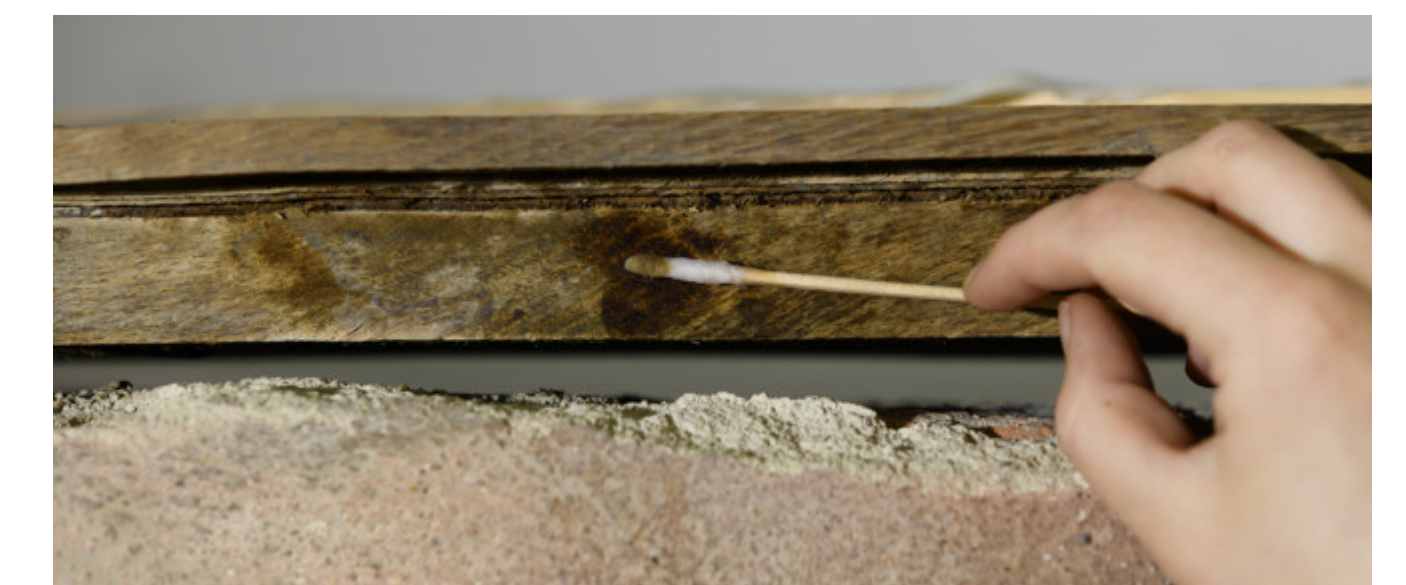
Kurative Behandlung des mikrobiellen Befalls.
